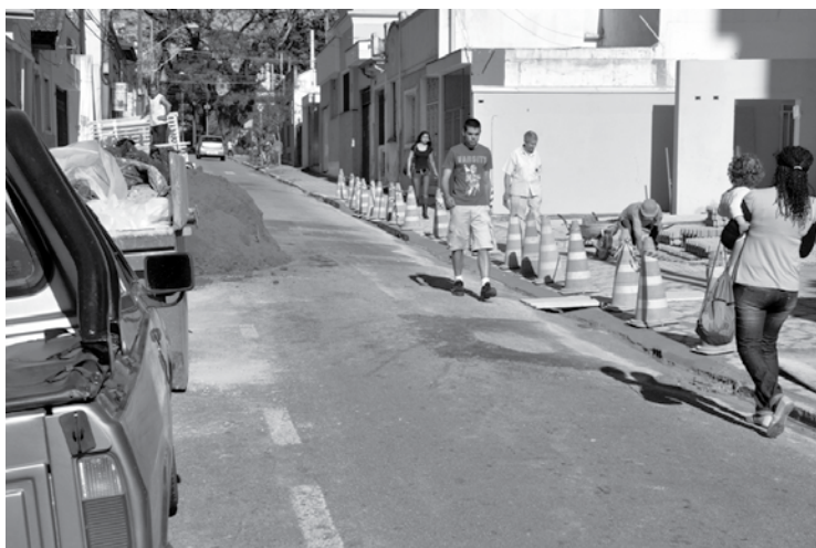
Obra da Ergplan não respeita os pedestres na rua do Correio ou Eng. Fernando de Mattos. Foto de 22 julho
