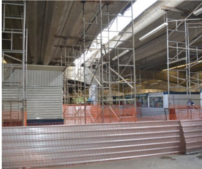
Telhas da Rodoviária Nova escoradas com estruturas provisórias; prédio não foi vistoriado pelo Corpo de Bombeiros antes de ser liberado para uso de viajantes
