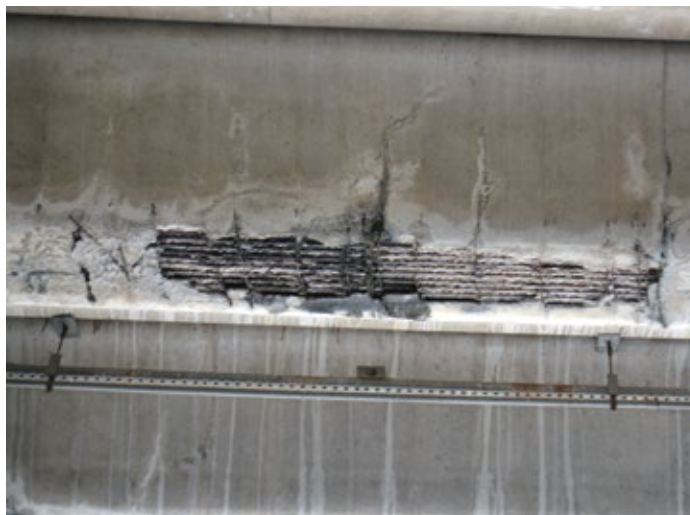
A longa falta de manutenção comprometeu grande parte da estrutura do terminal
