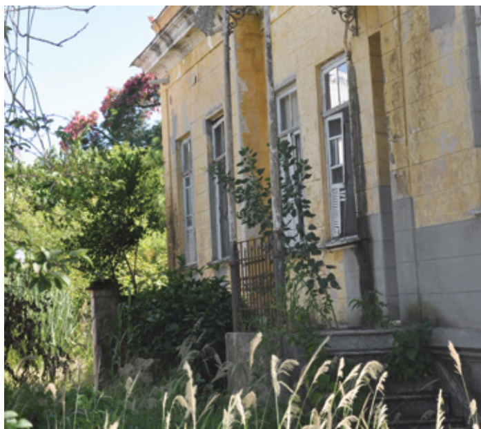
Abandonada, mato toma conta da Villa Santo Aleixo
