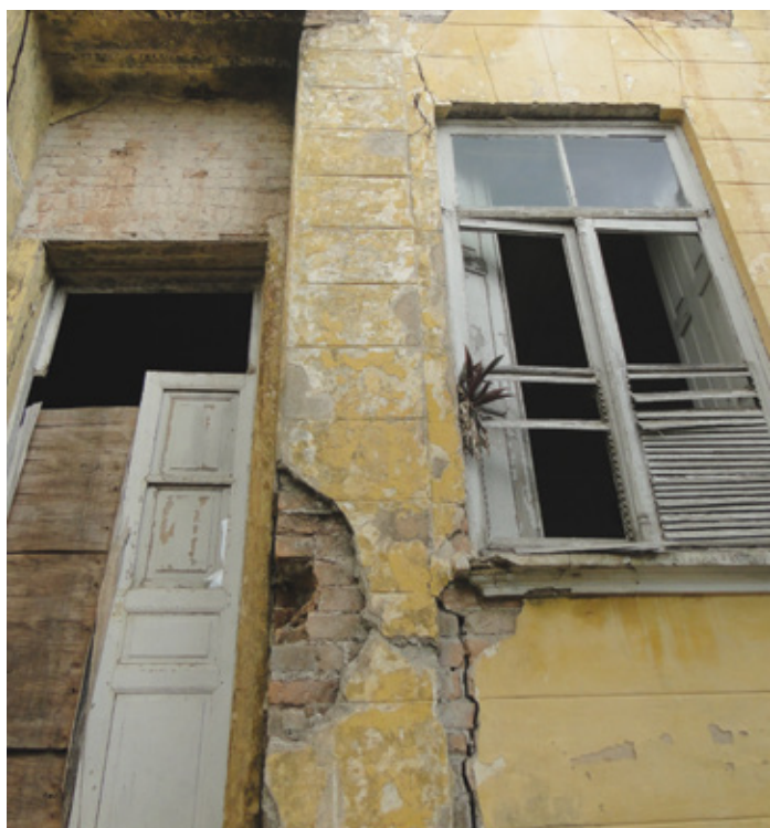
Abandono é pouco para o estado em que se encontra o patrimônio tombado
