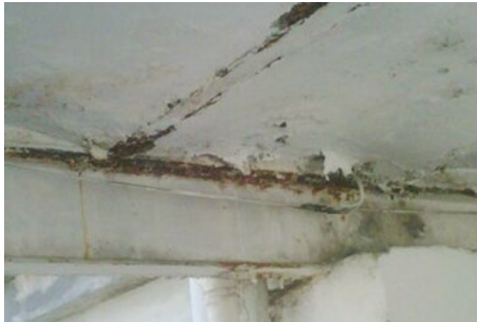
Marcas de infiltração e umidade tomam o teto da UTI Neonatal do HU
