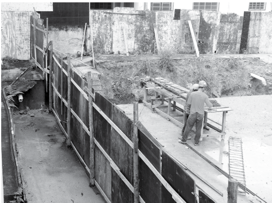
Tubulação exposta (à esquerda) por causa do rebaixamento do solo feito pela Ergplan lança águas pluviais que minam as bases da igreja do asilo Casas Pias
