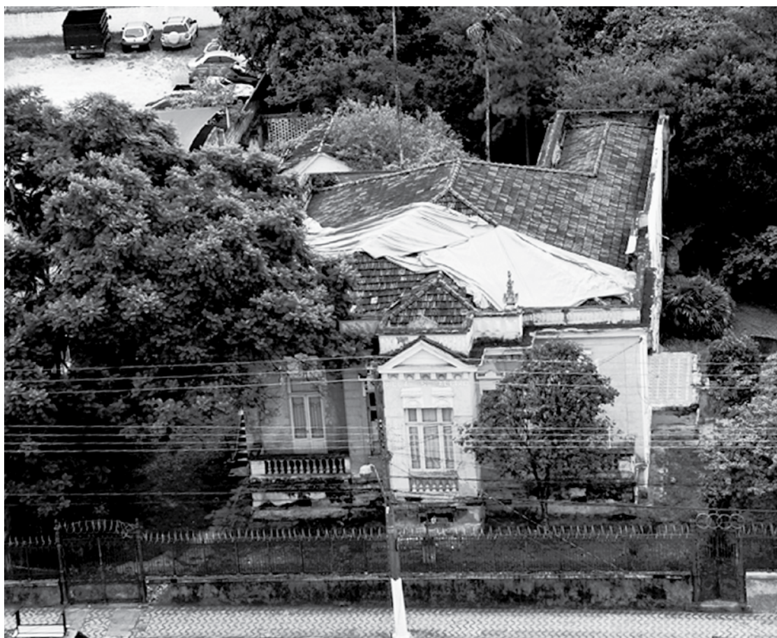
Vista aérea do prédio histórico da Vila Santo Aleixo. Lona no telhado foi a única providência tomada pelo poder público para preservar o local. Depois de se deteriorar a luz do dia a Prefeitura de Taubaté cedeu o imóvel para terceiros
