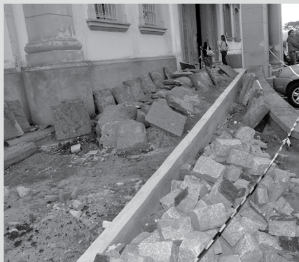
Rampa destruída e abandonada
