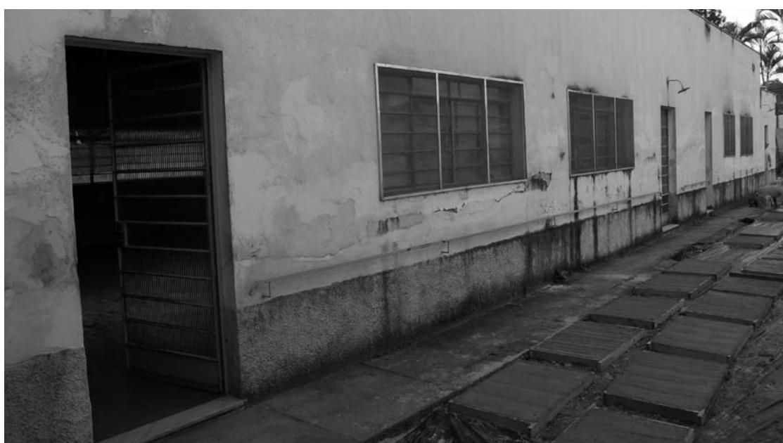
Entrada do refeitório do prédio onde funciona o asilo na Rua 4 de Março, em péssimo estado de conservação...
