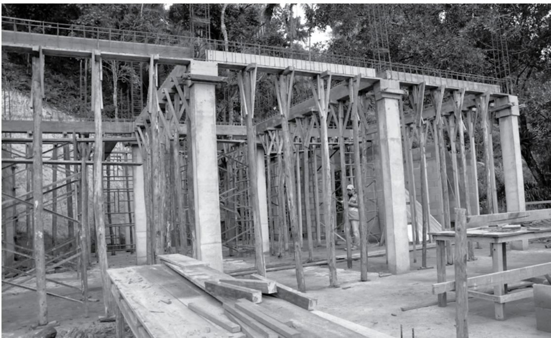
Colunas de concreto dão a dimensão do empreendimento erguido na ponta da Praia Grande
