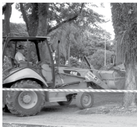
Canteiro de obras é exemplo de desrespeito
