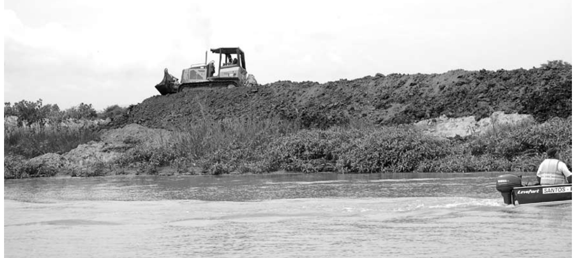
Flagrante de crime ambiental. Trator da empresa Pinheirinho Extração e Comércio de Areia Ltda em local proibido, próximo à margem do rio na faixa de proteção permanente
