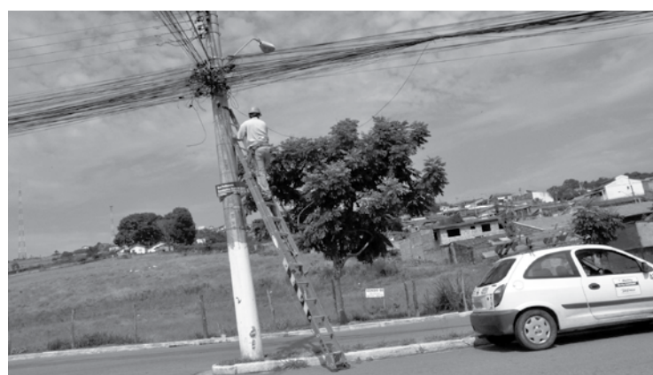
No tempo das fibras óticas e transmissão por satélite, na terra de Lobato a Telefonica só falta usar sinais de fumaça para provar seu atraso e o pouco caso da Prefeitura que finge nada ver como mostra a foto na rua Professora Escolástica Maria de Jesus, no bairro Baronesa
