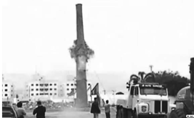
Frame de vídeo postado no YouTube mostra a demolição da chaminé da Embaré
