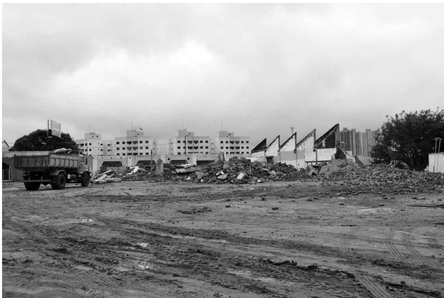
Escombros do que restou da chaminé da Embaré, na quarta-feira, 17
