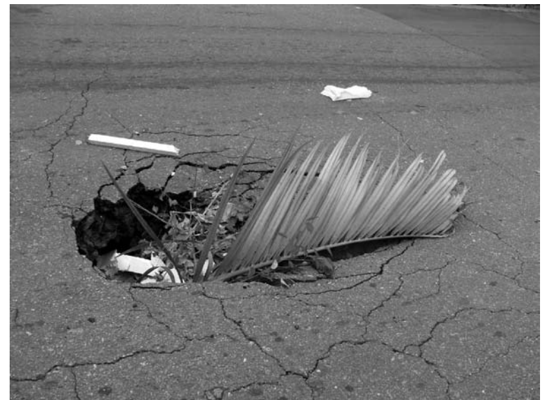
Buraco ao lado da casa do prefeito
