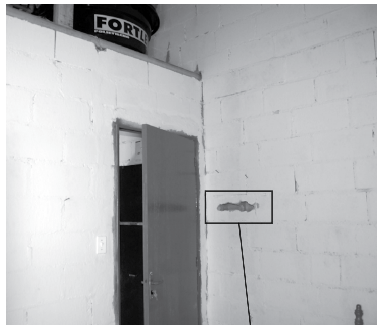
Casa citada na reportagem foi entregue com buraco na parede (detalhe)
