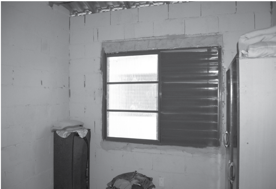
Acabamento mal feito na parte interna das casas
