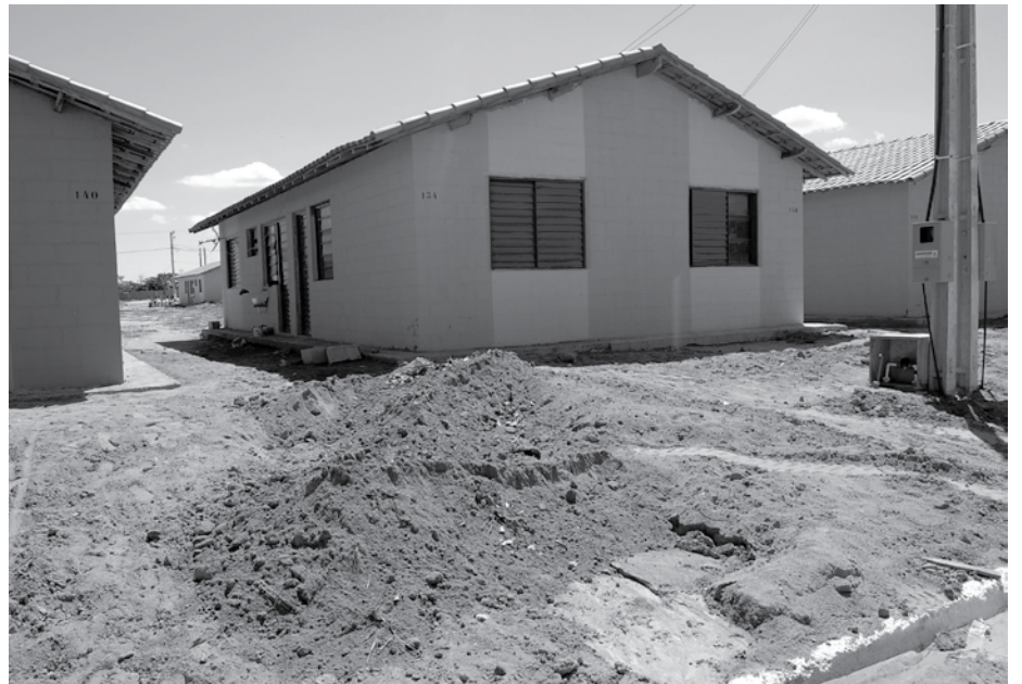
Falta de calçamento e os restos de terra provocam nuvens de poeira que sujam as residências
