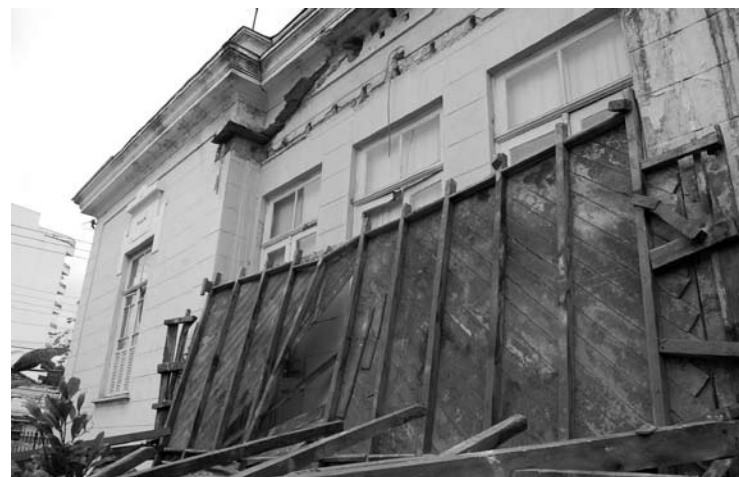
O abandono do edifício da Villa Santo Aleixo já provocou danos irreparáveis
