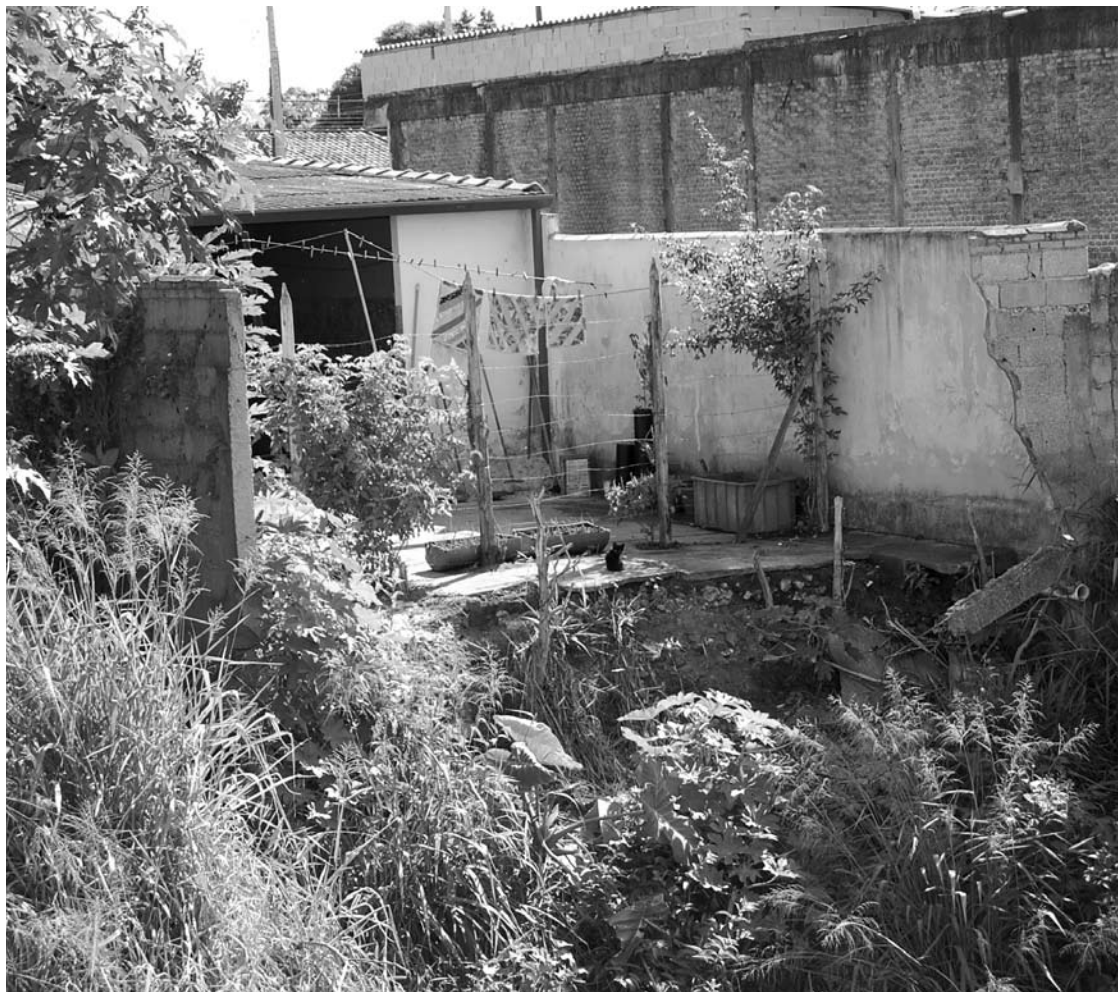
Parte da residência que foi levada pelas chuvas
