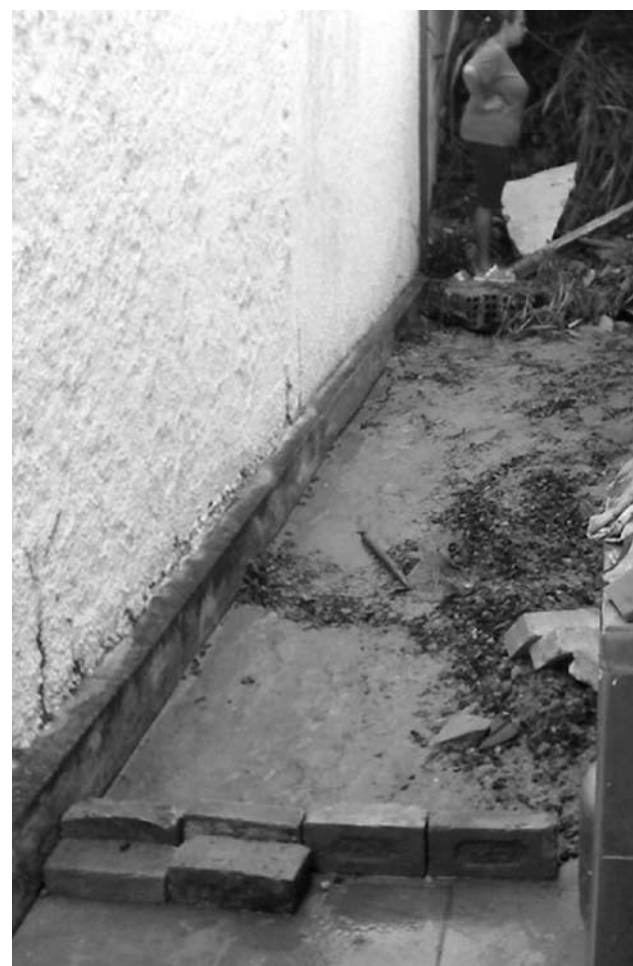
Foto do último deslizamento de terra
