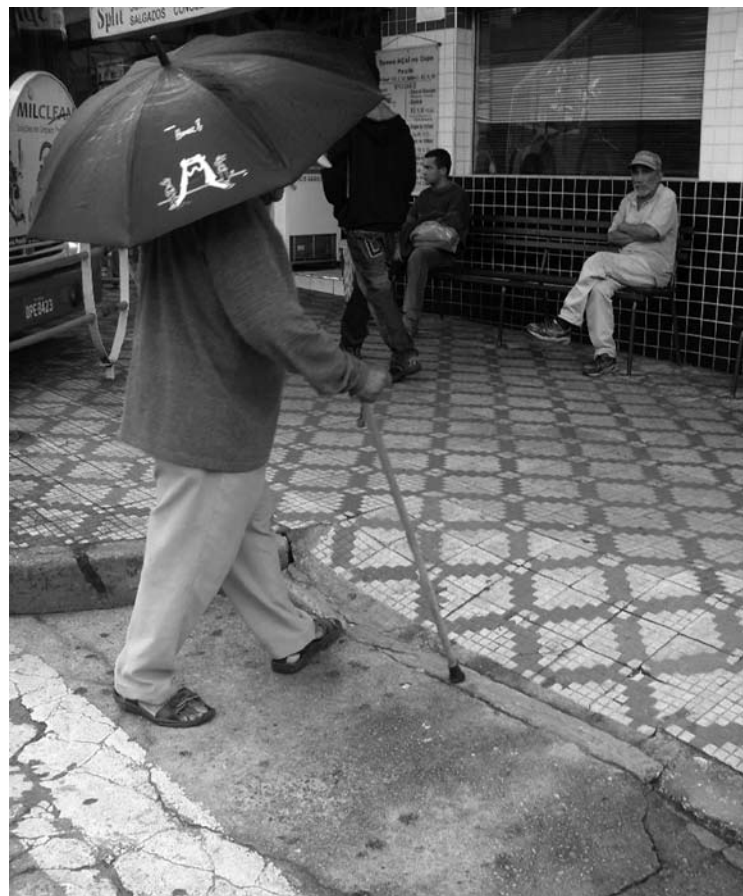
Guias rebaixadas em má conservação
