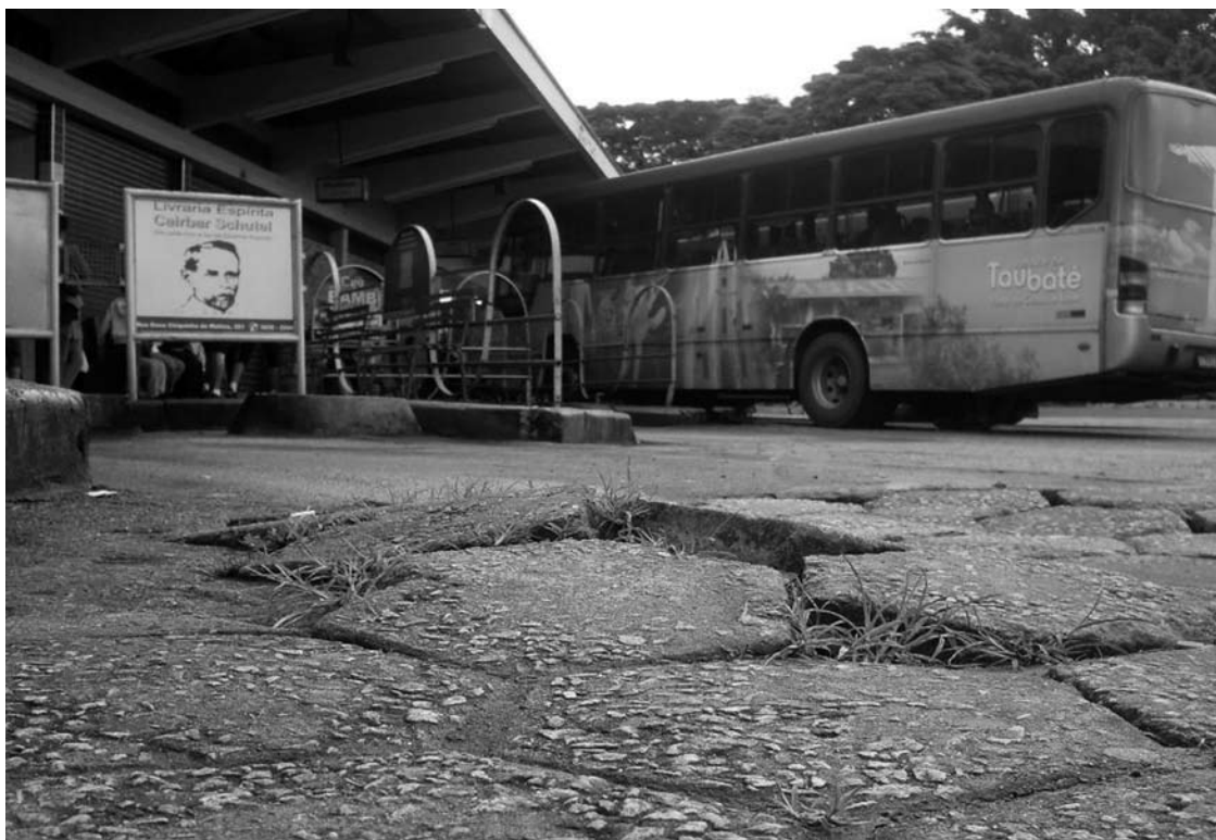
Buracos no acesso ao terminal rodoviário impossibilitam a passagem de pessoas com necessidades especiais
