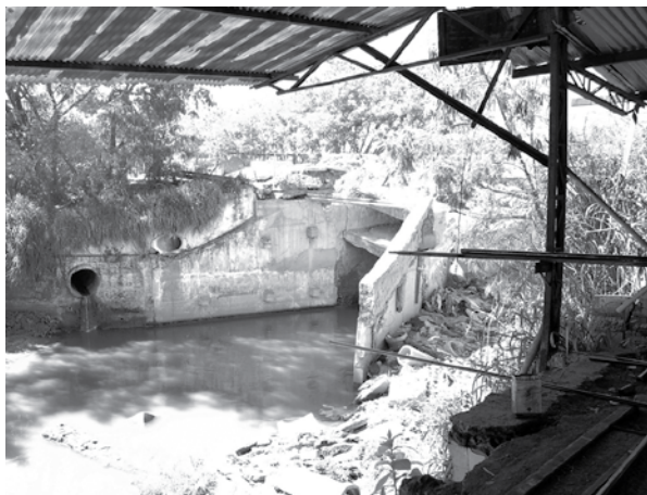
Fundos da oficina de portões que desabou junto com a ponte
