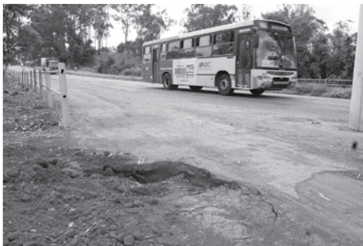
O enrocamento com pedras feito pela Prefeitura recentemente também começa a ceder. Sem dúvida, uma obra provisória.
