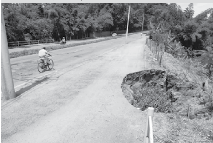
Erosão na avenida Carlos Pedrosa Silveira, no Km 128 da antiga rodovia Rio/SP, próximo ao bairro do Pinhão
