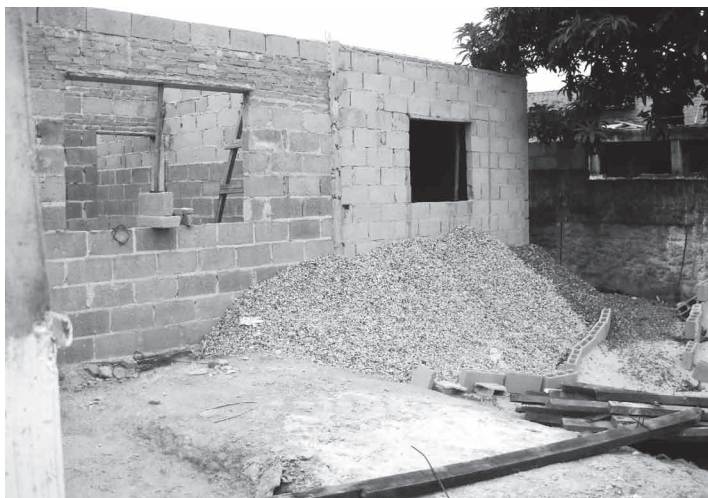
Contra lei. Casa construída em via pública
